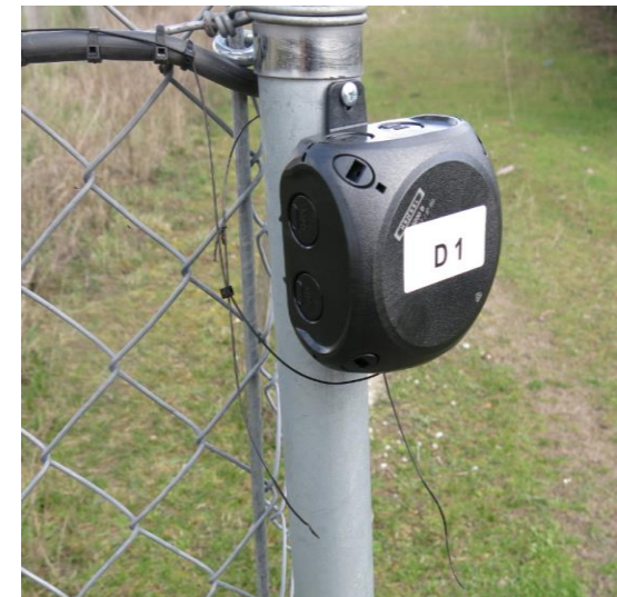
Reißdraht auf flexiblem Zaun mit loser Verkabelung zur Abzweigdose
