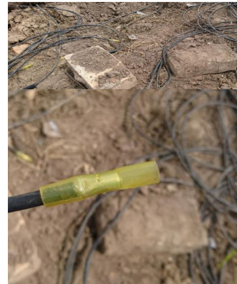
Ungeordneter Kabelgraben. Zu kurze Strangkabel unsachgemäß für Erdverlegung zur Verlängerung vorbereitet.
